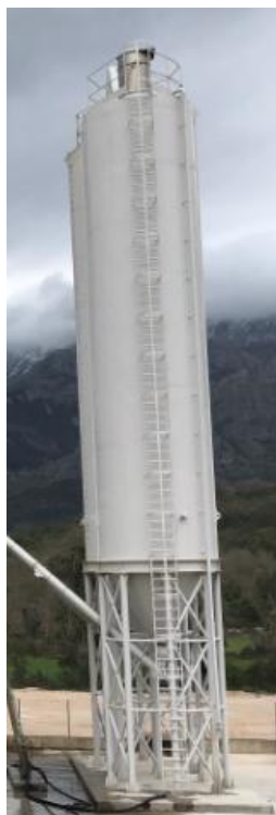
Slika 9. Silosi za skladištenje cementa
