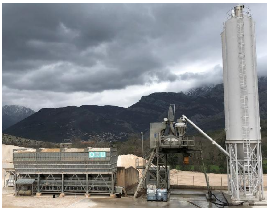
Slika 7. Postrojenje za proizvodnju betona
